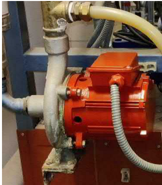
Vuotoa/korroosiota pumpun yhteydessä.
