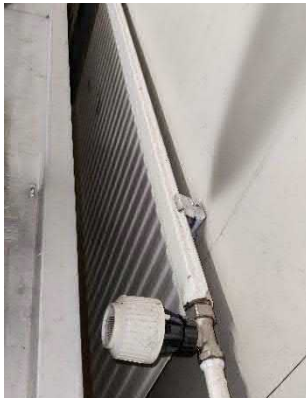
Patterikytkentä ja termostaatti
