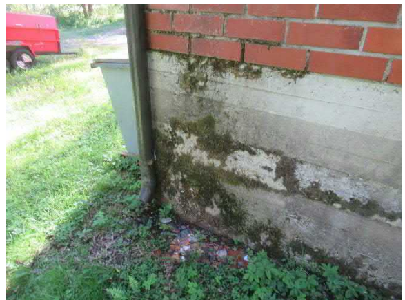
Pohjoisnurkassa vesivaluman aiheuttamaa kas- vustoa ja tummentumaa
