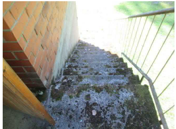
Portaissa sammalta ja rapaumaa, kaiteessa pinnoite- ja korroosioaurioita.
