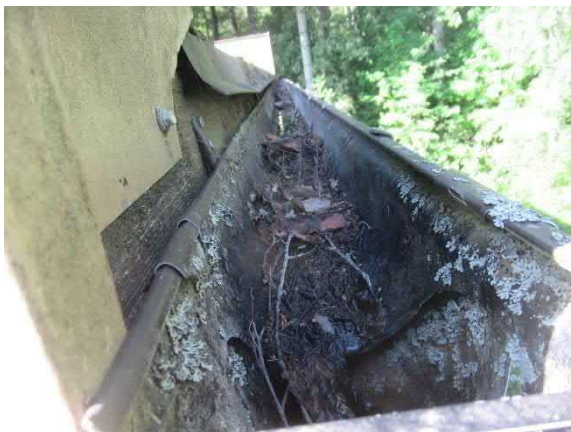
Sadevesikouruissa runsaasti roskaa (metsä lähillä, vaatii aktiivista kunnossapitoa)
