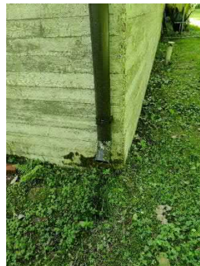
Hulevedet valuvat rakennuksen vierustalle
