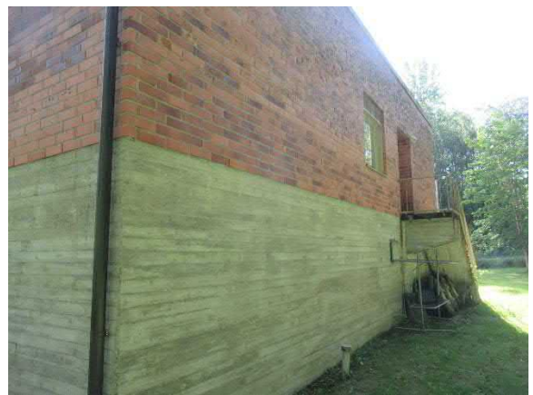
Yleiskuva päätyjulkisivusta (lounaaseen), muurauksessa sammalkasvustoa
