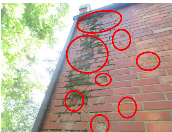
Pohjoiskulmauksen valumajälkiä, rapautuneita tiiliä (punainen ympyröinti)
