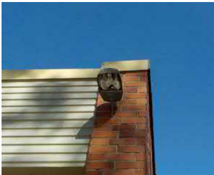
Ulkovalaisin seinään asennettuna
