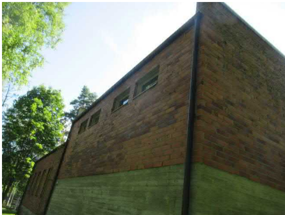
Takapihanpuoleinen julkisivu (luoteeseen), tiili- muurauksessa sammalkasvustoa
