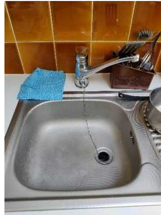
Keittiön hana, liikerajoitus puuttuu.
