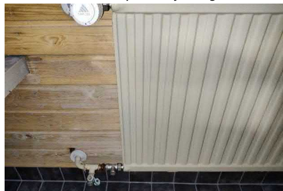
Korroosiota lämmityspatterin kytkennässä/yhdistäjässä
