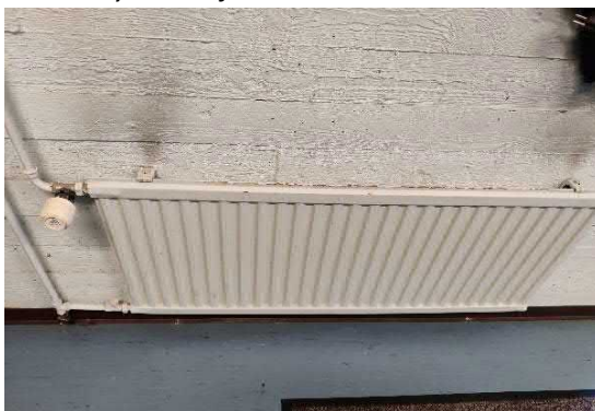
Korroosiota ja maalin irtoamista lämmityspatterin päällä
