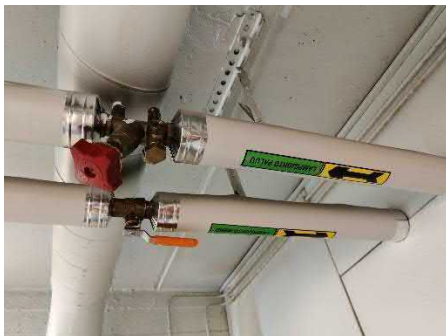
Lämpöjohdoissa olevat sulku ja linjasäätöventtiilit
