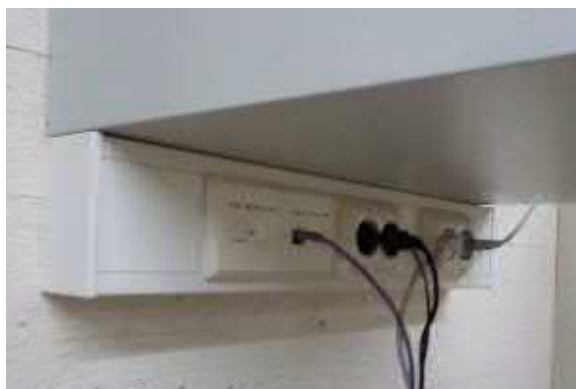
Johtokanavaa työpisteellä väestönsuojassa
