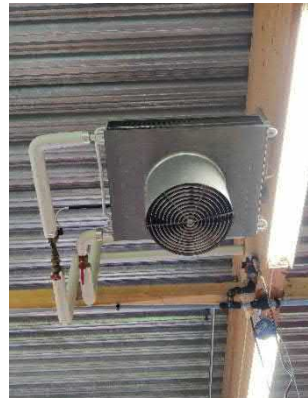
Kiertoilmakoneen kytkentä ja magneettiventtiili
