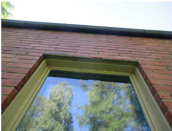
Ikkunan ylityspalkissa alkavaa rapaamaa
