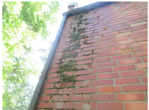
Valumajälkiä, todennäköisesti peräisin vauriointeesta sadevesikourusta
