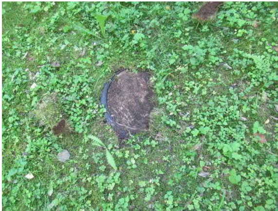
Mahdollinen salaojakaivo, ei saatu auki
